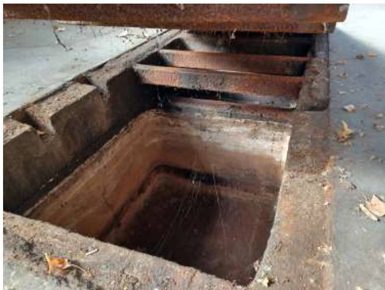
Figure 5 : Séparateur d'hydrocarbures curé
